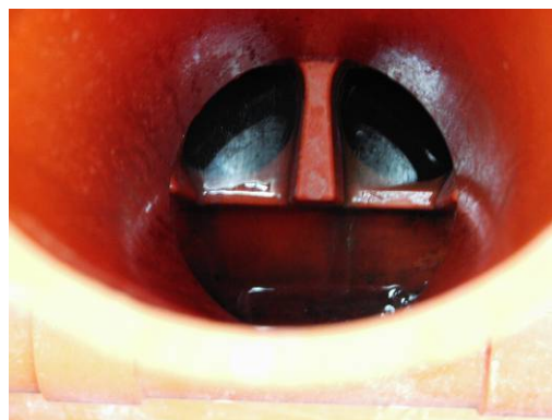
接戶後排水情況
