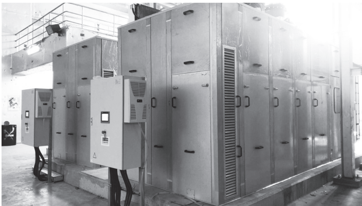
汰換更新後之單段離心式鼓風機（迪化廠）
