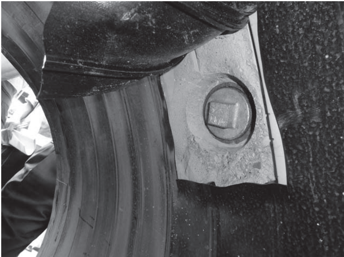
照片-12 由管內所見之灌漿孔(加工技術粗糙末端折損防蝕加工效果存疑···)
