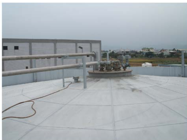
圖 7 浮動蓋式消化槽-本中心(鋼構)
