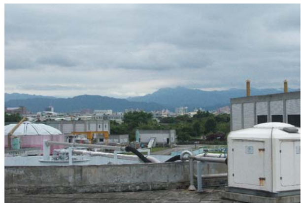
圖 5 沼氣壓縮機與攪拌管線
