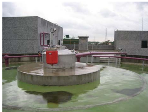
圖 8 固定蓋式消化槽-它廠(RC)
